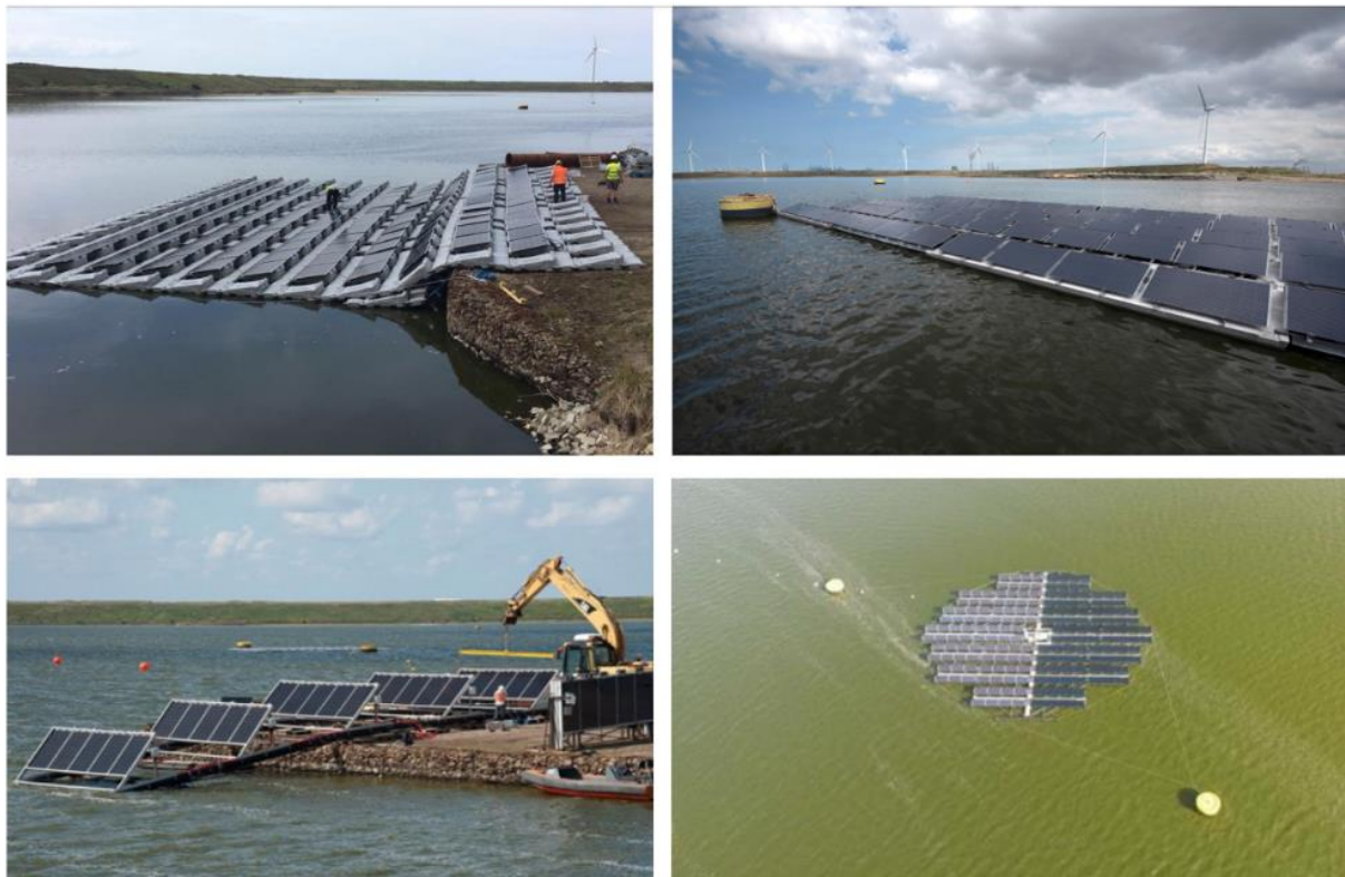
Figuur 1: De vier concepten in de pilotstudie op de Slufter, vanaf linksboven met de klok mee: Wattco - Profloating, Texel4Trading - Solar Float, FloatingSolar/SunProjects en Sunfloat
